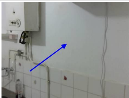
Photo n° PhA004 Localisation : Cuisine; WC; Salle de bains Ouvrage : 3 - Parois verticales intérieures - Cloisons sèches (assemblées, préfabriquées) Partie d'ouvrage : Enduits à base de plâtre ou ciment projetés, lissés ou talochés Description : Enduits à base de plâtre ou ciment projetés, lissés ou talochés
